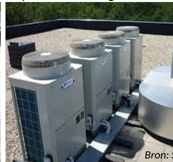
Collectieve warmtepompen op het dak
