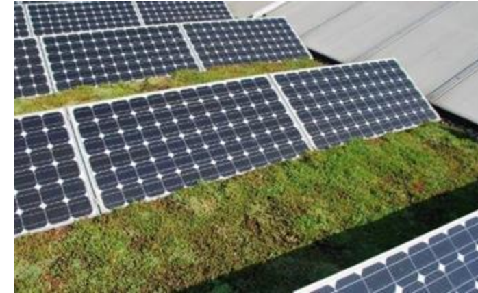
zonnepanelen op sedumdak
