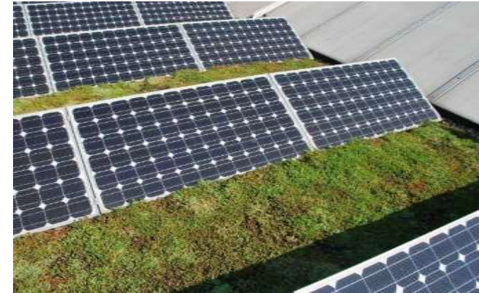
zonnepanelen op sedumdak
