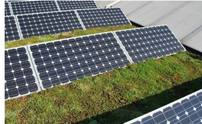
zonnepanelen op sedumdak
