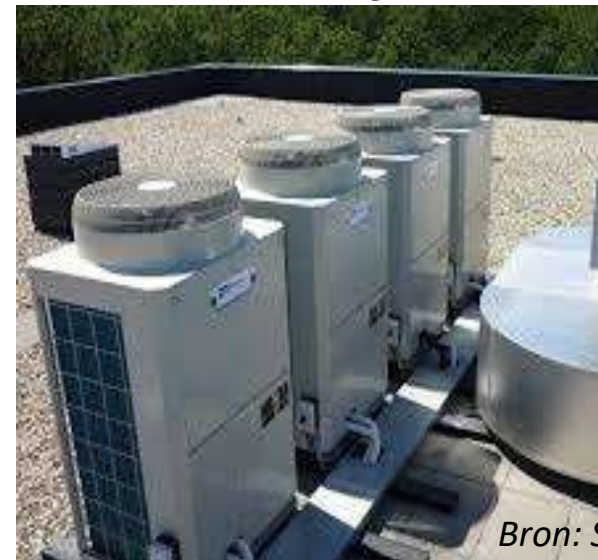
Collectieve warmtepompen op het dak
