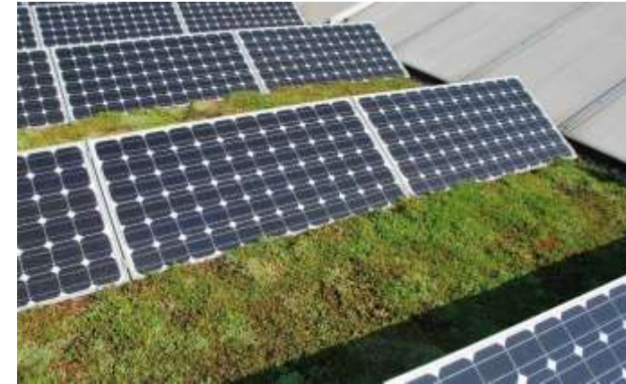
zonnepanelen op sedumdak
